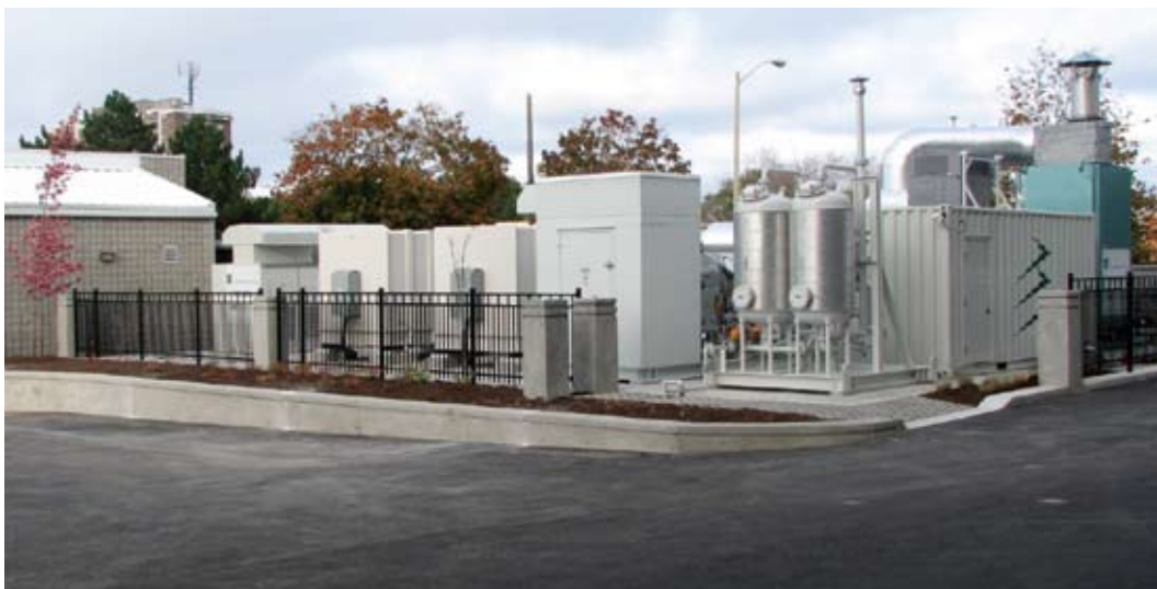
Photo : Centrale de production d'électricité à pile à combustible direct par récupération d'énergie d'Enbridge Gas Distribution et de FuelCell Energy, à Toronto, en Ontario
