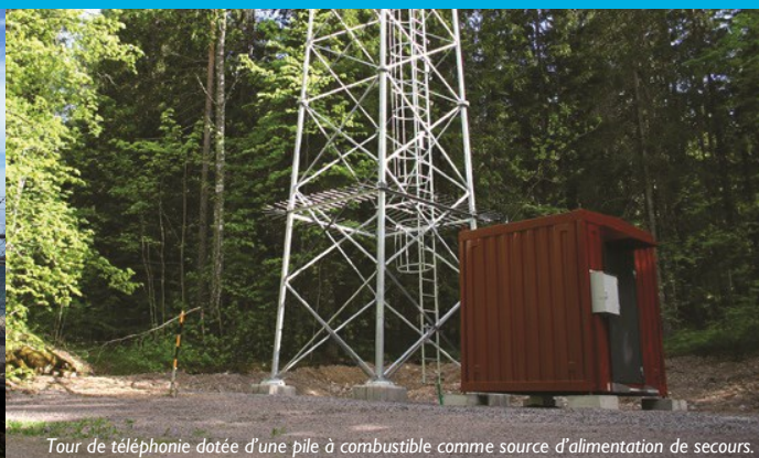
Tour de téléphonie dotée d'une pile à combustible comme source d'alimentation de secours.
