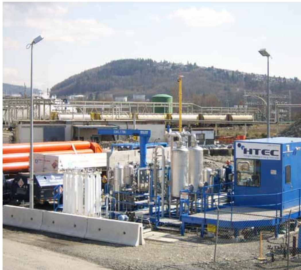
Installation de capture d'hydrogène HTEC à Vancouver nord, C.B.
