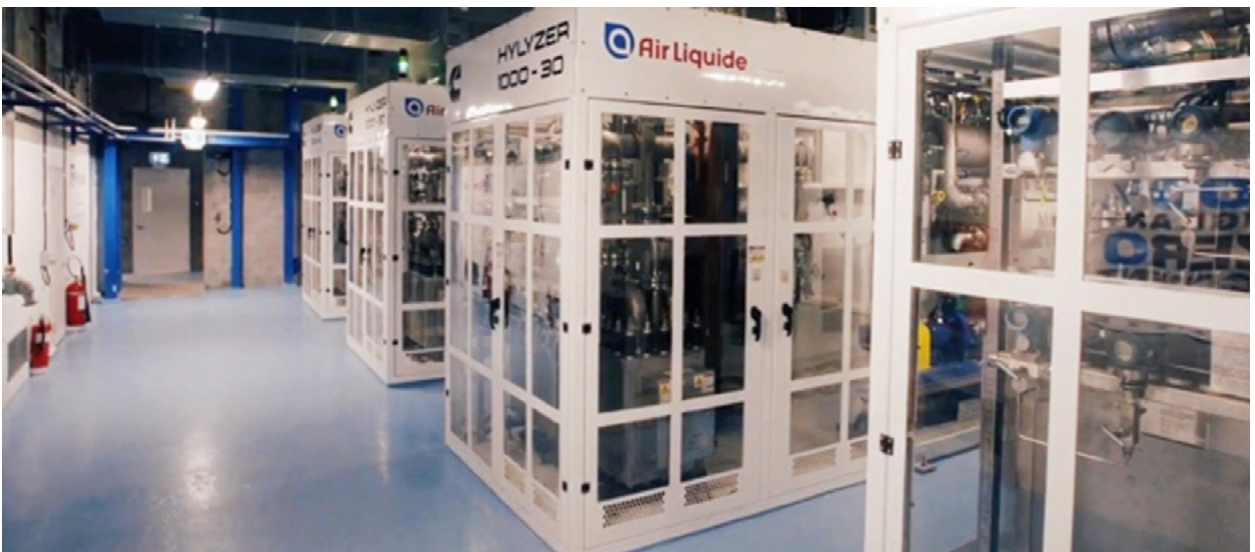
Figure 5: Modules d'électrolyseurs à l'installation d'hydrogène vert de 20 MW d'Air Liquide à Bécancour, au Canada, soutenant les matériaux de batteries et la grappe industrielle existante au Québec. Source: Air Liquide.
